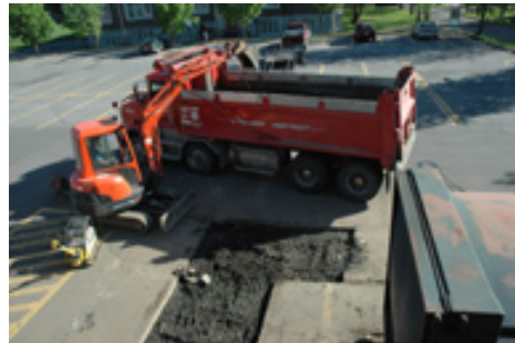
Figures 9-16 Dalle de béton armé en construction pour accueillir un bio-réacteur : (a) marquage du sol, (b) excavation, (c) dalle coulée qui sèche, (d) dalle prête à accueillir le composteur; (e) Comme alternative économique à une dalle de béton pour supporter un composteur, utilisez des plaques d'acier pour répartir le poids
