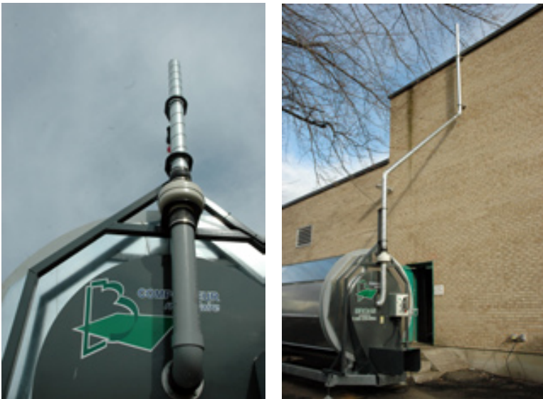
Figure 11-25 Cheminée pour évacuer et diluer l'air sortant d'un composteur (a) cheminée de faible hauteur installée dans une aire ouverte près d'une institution et (b) cheminée qui surplombe le toit d'un commerce
